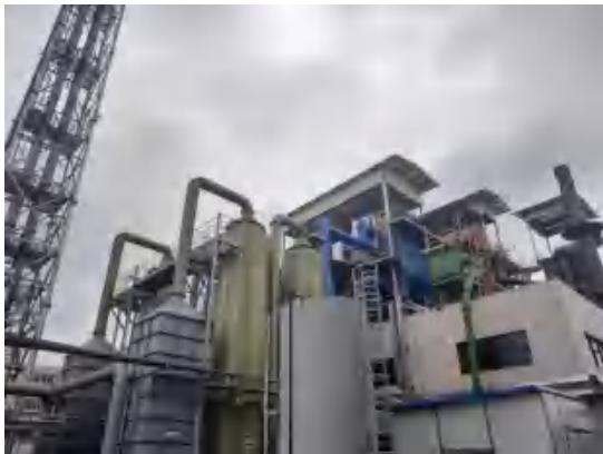
再生烟气处理设施
