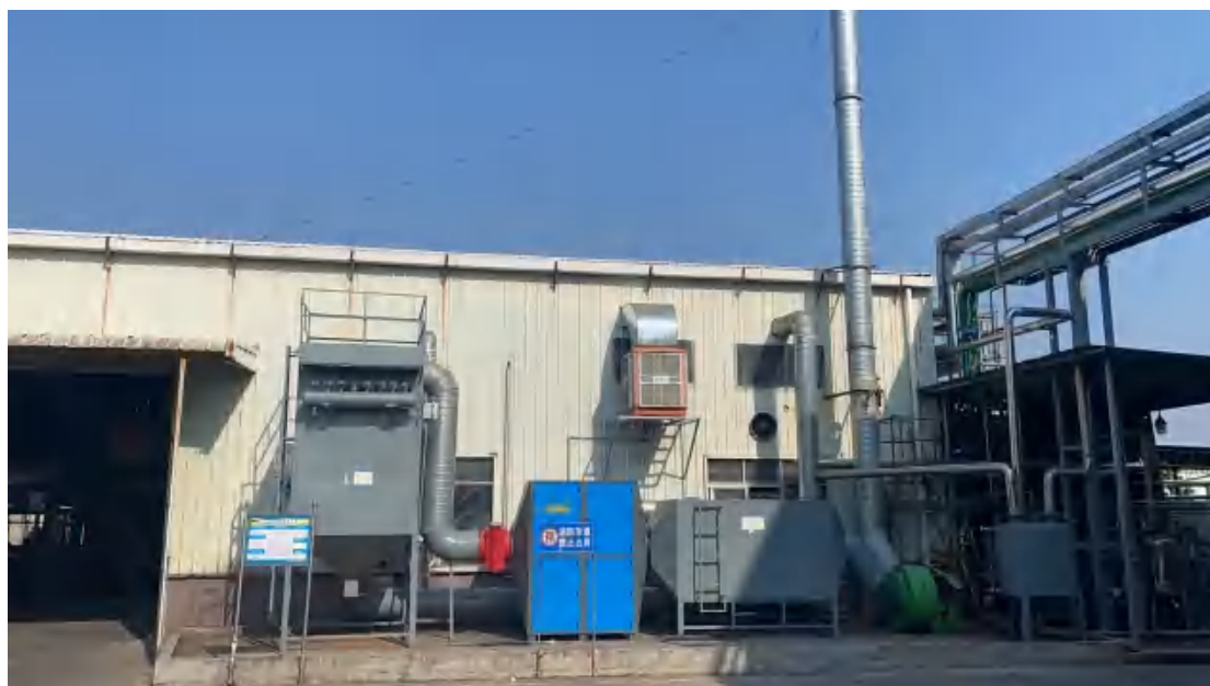
图 4-4 甲类车间二“布袋除尘+UV 光解装置+活性炭吸附”装置
