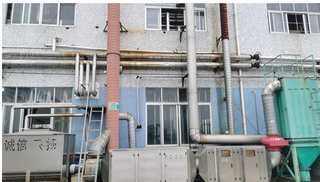
图 4-3 甲类车间 A “布袋除尘+UV 光解+活性炭吸附”装置
