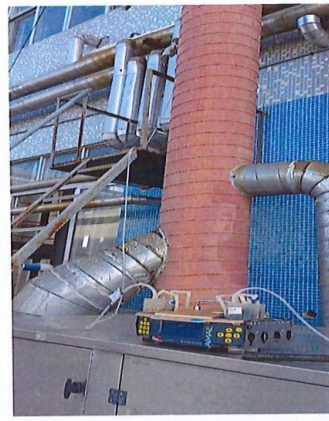
甲类车间 A 排气筒处理后
